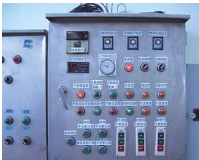
圖3 安裝于半開放式棚架溫室之模組化環控箱已進行連結運轉。
