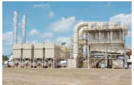
圖 13. 蓄熱式燃燒爐（regenerative thermal oxidizer, RTO）
