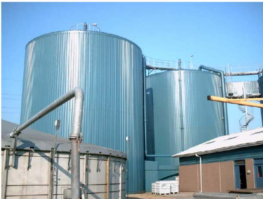
Ribe 沼氣廠內厭氣發酵槽(中間)及糞泥等原料儲存槽(左)外觀
