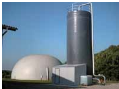
LinkoGas 沼氣廠內沼氣儲存袋槽 (左) 及沼氣脫硫 (右) 設施外觀
