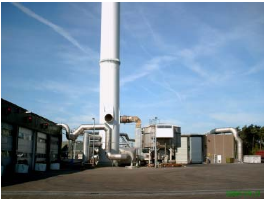
圖 5. 德卡生物工業公司在 Randers 化製廠之臭氣燃燒處理設施
